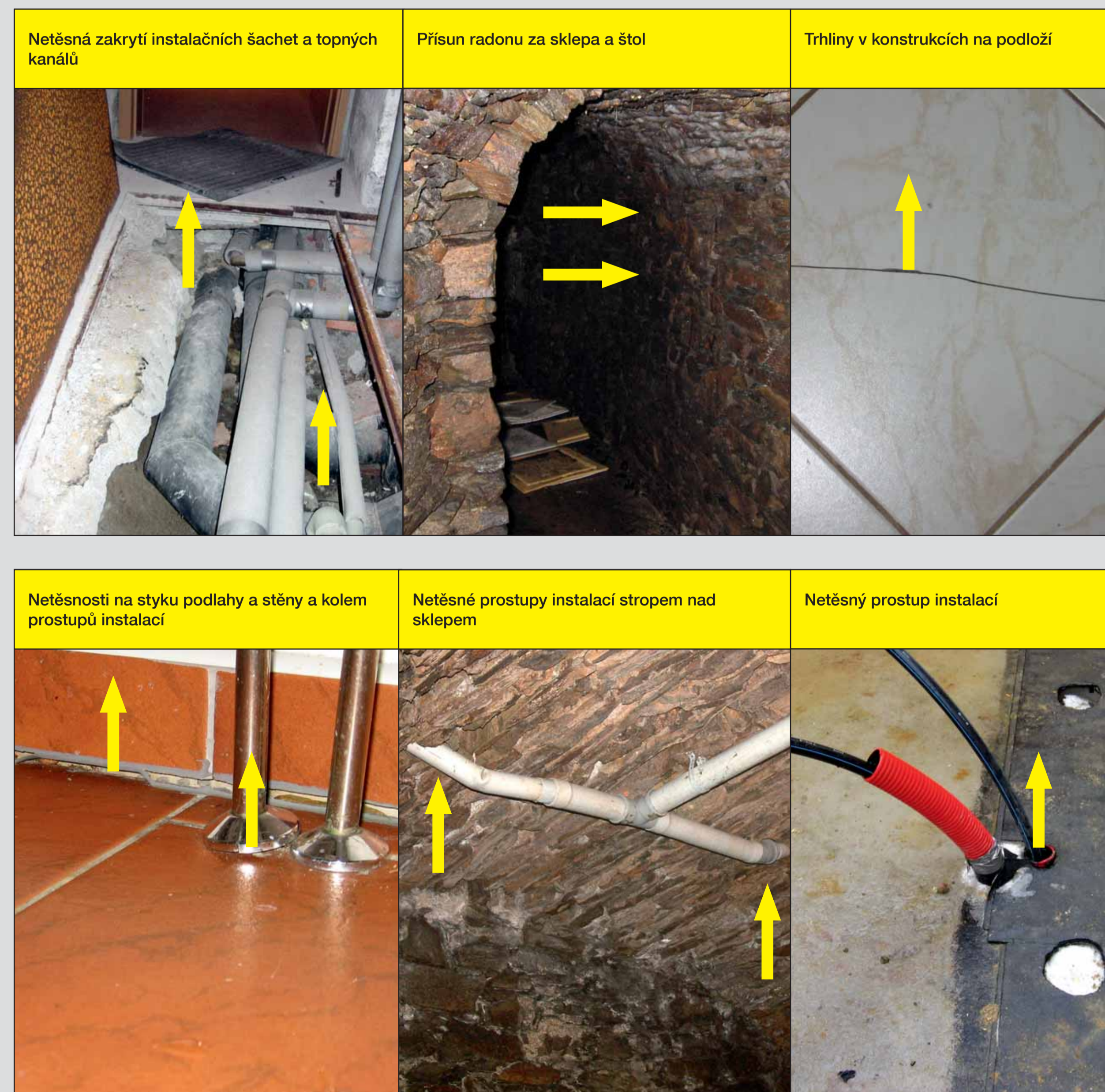
Obr. 2 – Radon vstupuje do domu nedostatečně utěsněnými šachtami, trhlinami, netěsnostmi kolem prostupů inženýrských sítí, netěsnými prostupy stropem nad sklepem, vsakovacími jámkami, trativody atd. Pro Jáchymov je typickým zdrojem radonu i sklep vytesaný ve skále za domem, do něhož se vstupuje přímo z domu.
